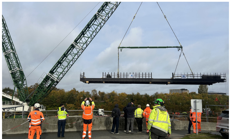
Her kan I se billeder af den enorme kran, som med millimeterpræcision løftede den første del af den tonstunge stålbro på plads over de forstøbte beton-brokonsoller.
